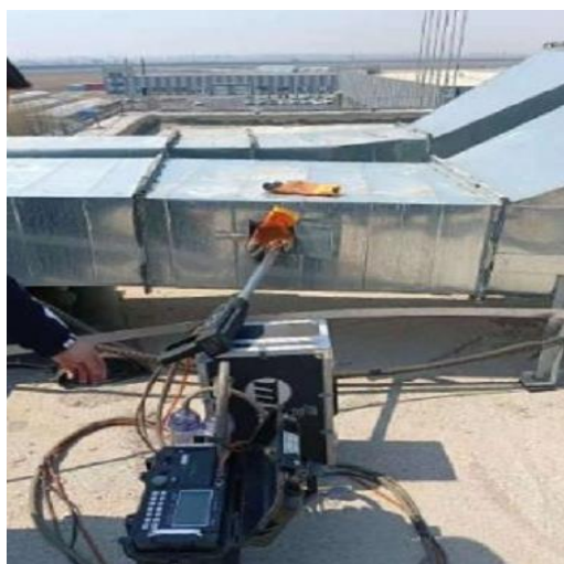
食堂油烟净化设施出口
