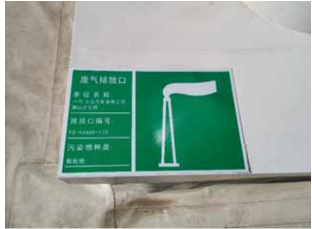
照片 4-10 焊接废气排放口标识牌 (FQ-46469-173)
