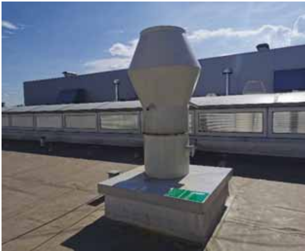
照片 4-11 焊接废气排放口 (FQ-46469-174)
