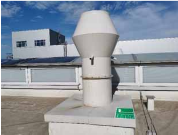
照片 4-9 焊接废气排放口 (FQ-46469-173)
