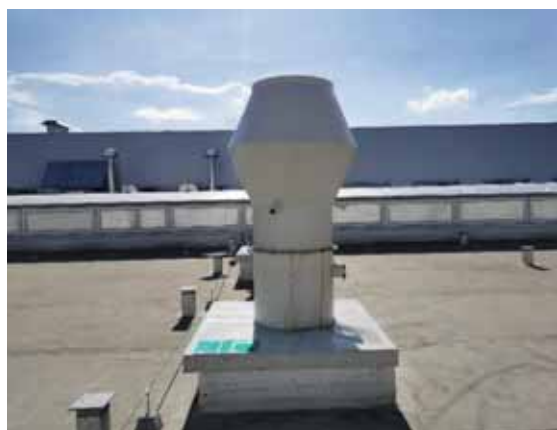
照片 4-7 涂胶废气排放口 (FQ-46469-172)
