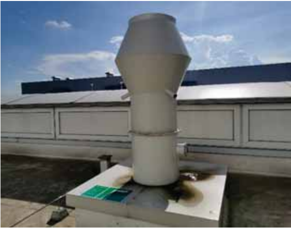
照片 4-15 焊接废气排放口 (FQ-46469-176)
