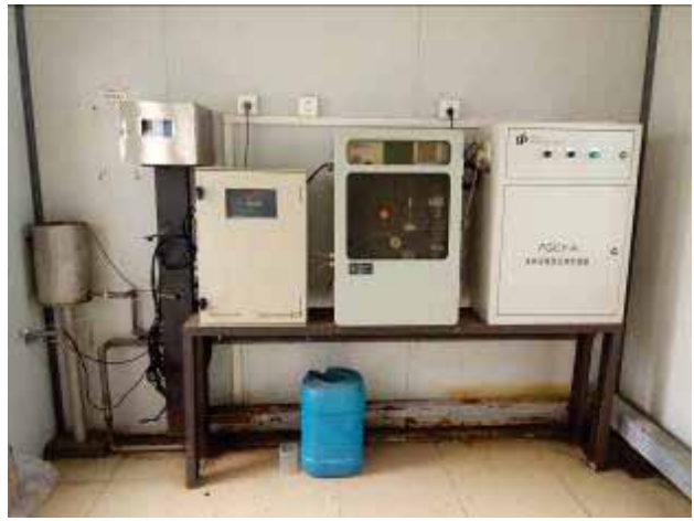
照片 4-20 外排废水在线监测系统
