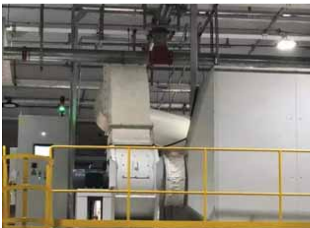
照片 4-3 涂胶废气处理设施
