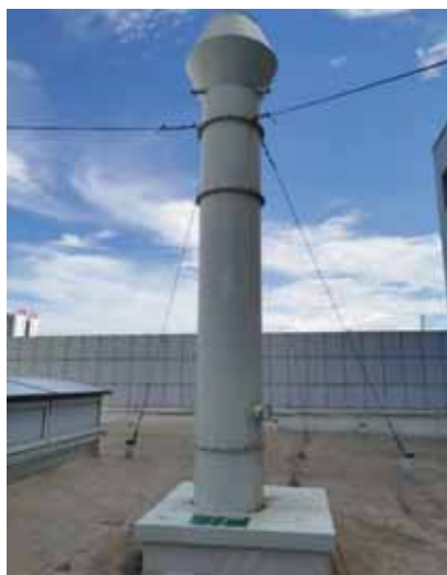
照片 4-5 涂胶固化废气排放口 (FQ-46469-170)
