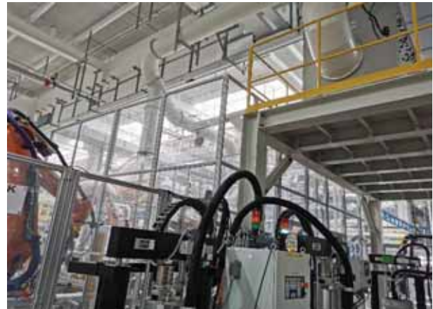
照片 4-2 涂胶废气围蔽收集系统
