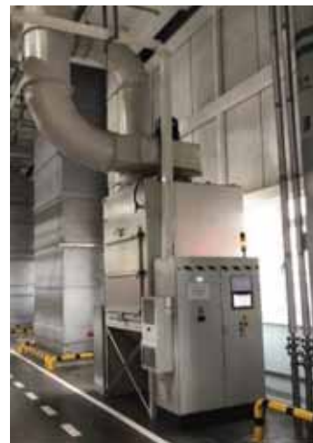
照片 4-4 焊装废气处理设施
