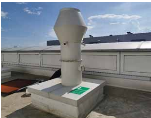
照片 4-13 焊接废气排放口 (FQ-46469-175)
